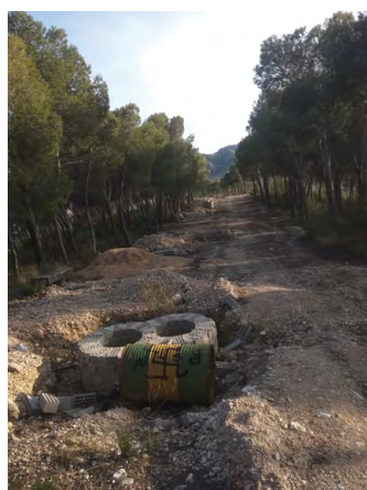
Mal estado y peligroso del paseo central del segundo cabezo
