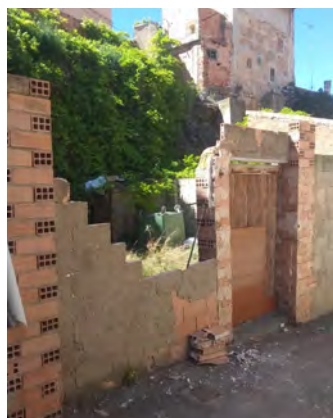
Pared derribada. Dentro el contenedor. Vandalismo puro.
